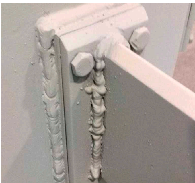
Figura 8. Unión en ángulo con exceso de sobreespesor, mordeduras y proyecciones. Por el aspecto que se muestra, es presumible que no tiene suficiente penetración.
