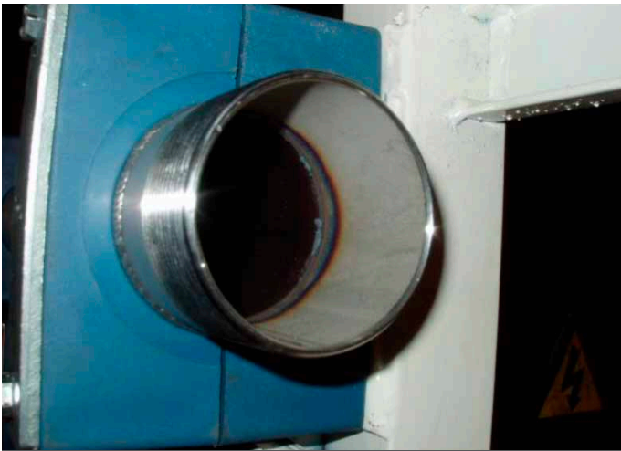
Figura 7. Corrosión en la pasada de raíz de un tubo inoxidable unido a un tubo de acero al carbono.
