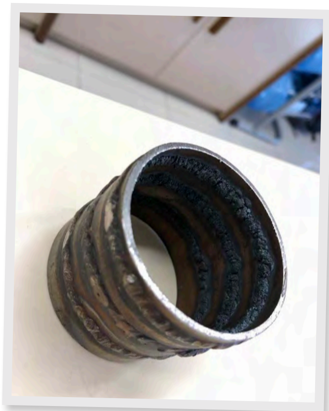
CESOL - Oxidación de la raíz al soldar una tubería de acero inoxidable
